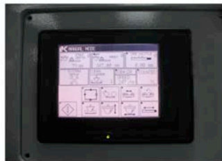
SPS-Steuerung mit Touch Screen Bedienfeld
