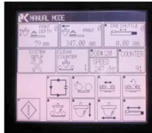
SPS-Steuerung mit Touch Screen Bedienfeld
